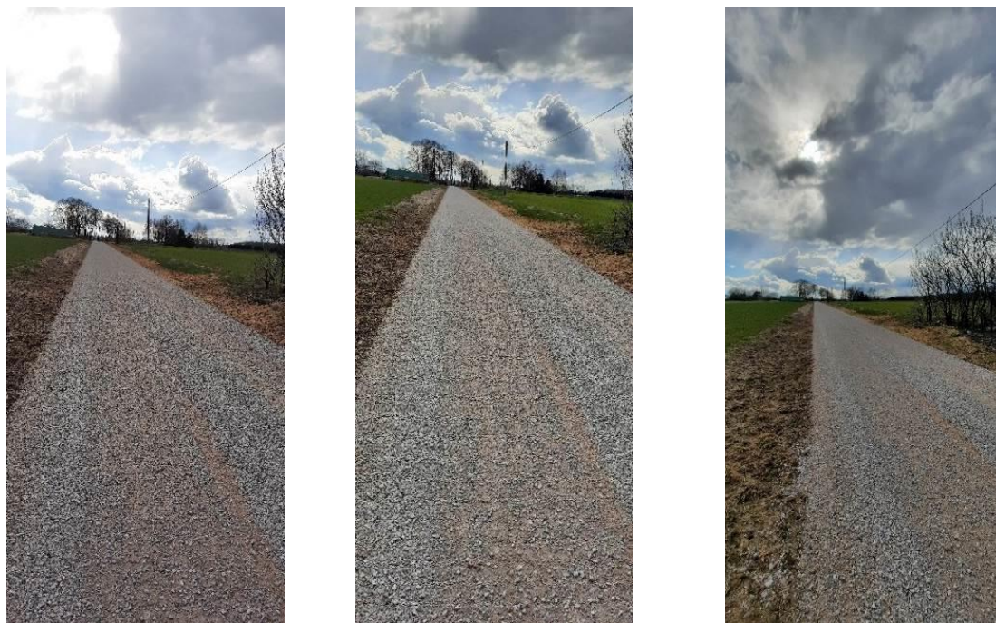
Zdjęcie 5.3.12., 5.3.13 i 5.3.14. Przebudowa drogi wewnętrznej w miejscowości Tworowice na działce o nr ewid. 483 obręb 0018 Tworowice
