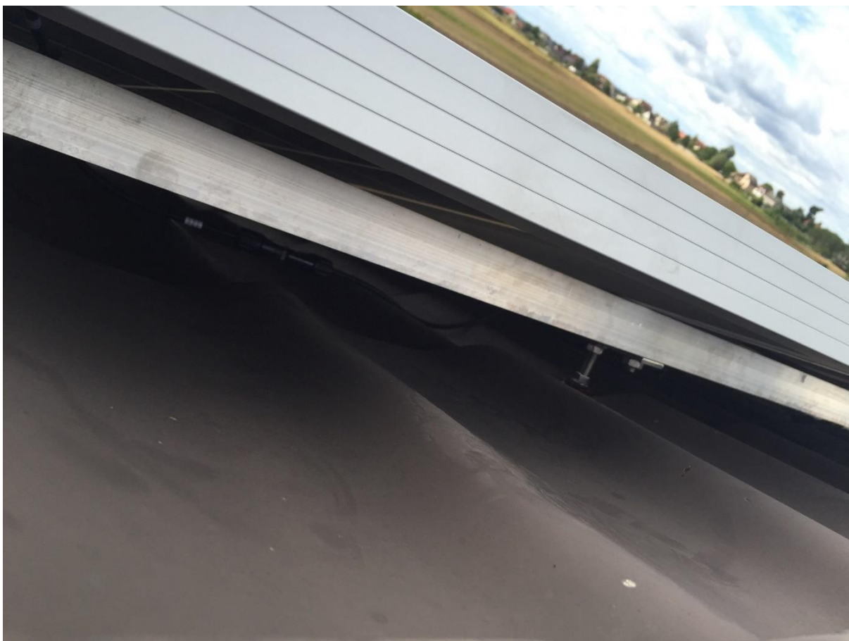
Przykładowa instalacja na dach skośny
