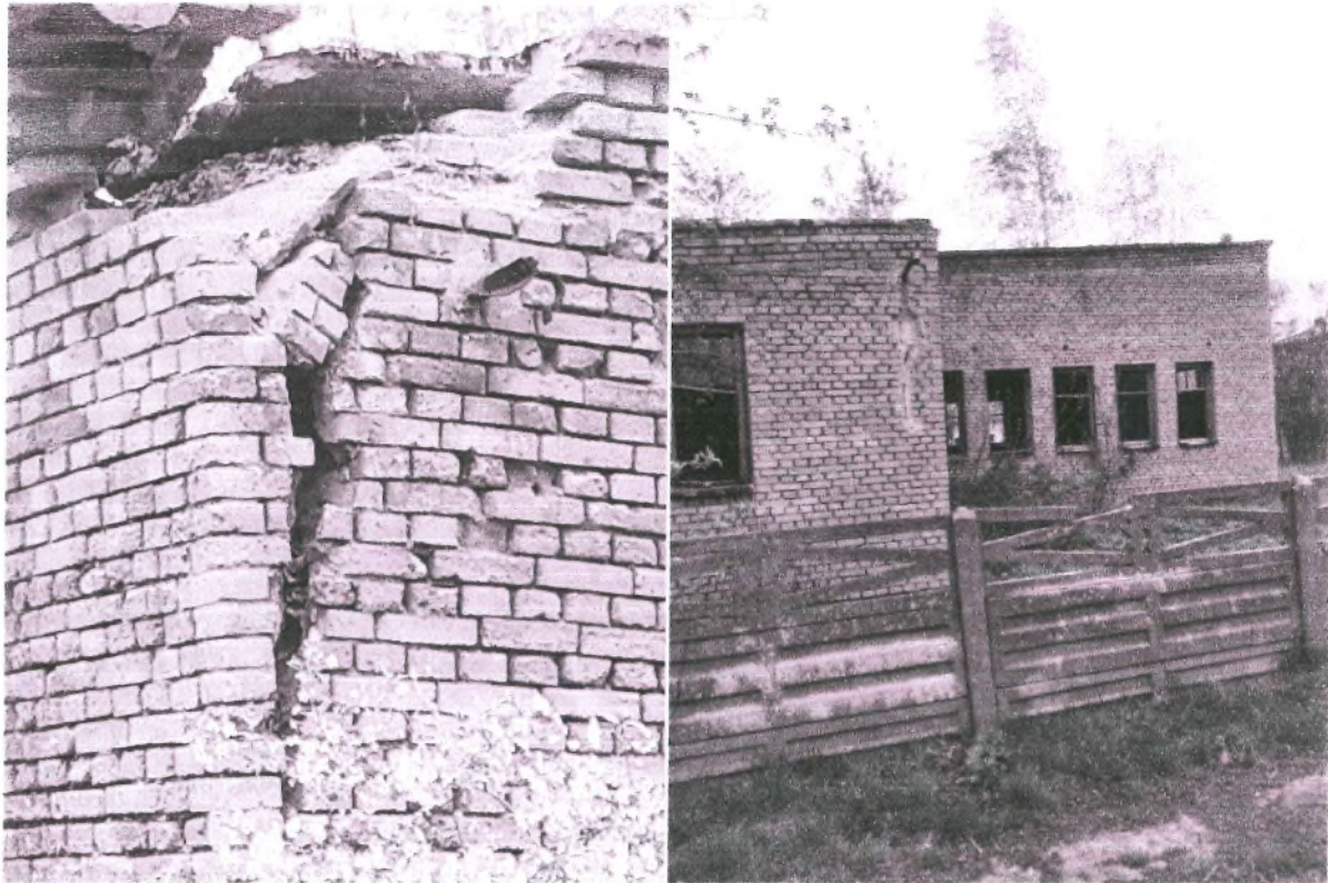
Zdjęcia 1 i 2. Widoczny opustoszały budynek OSP w m. Ochotnik, który stanowi zagrożenie dla mieszkańców i grozi zawaleniem
