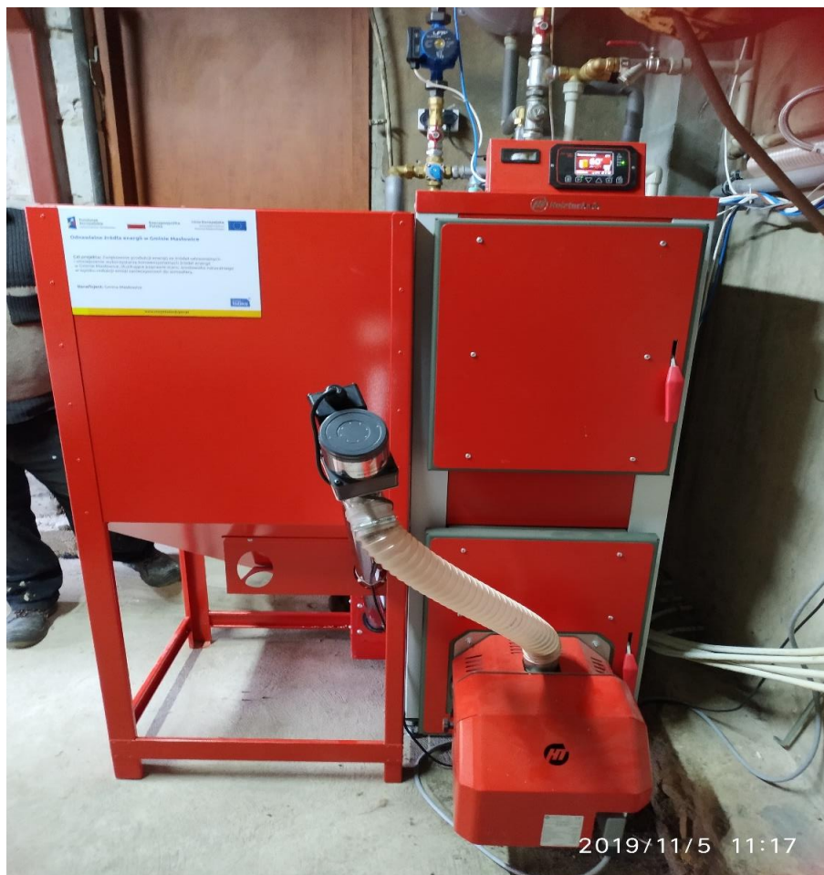
Zdjęcie 2.6.21. Jeden z 3 zamontowanych pieców na biomase
